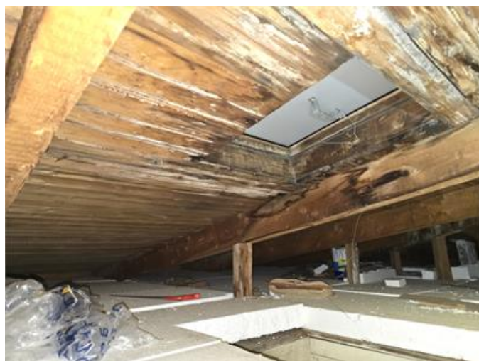
Exempel på påväxt på underlagstaket och fuktfläckar.
