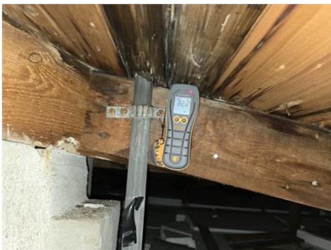
Förhöjda fuktindikationer kring genomföring på vind.
