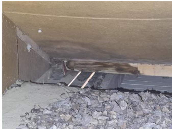
Fuktfläckar på vindens underlagstak.
