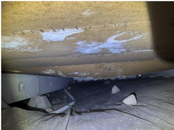
Mikrobiell påväxt på blindbottenskvivor i krypgrund.
